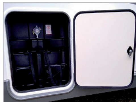
Fig.6.30 - Vano delle bombole del gas
